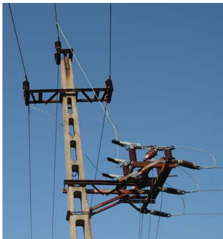
9. fotó: Példa egy összetett fejszerkezetű oszlopra: a tartófejszerkezet alatt egy vezetékálgazás van oszlopkapcsolóval (Fotó: Balázs István).
