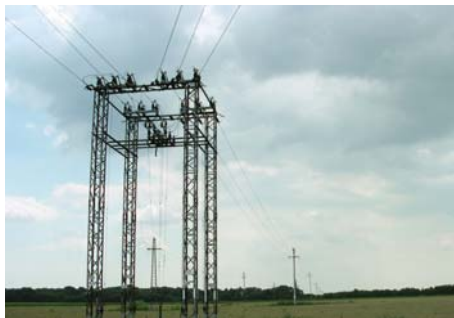
4. fotó: A nyílt élőhelyen futó vezetékcszakaszok kapcsoló-, vagy feszítő-fejszerkezetű oszlopai jelentik a legnagyobb veszélyt a madarakra (Fotó: Demeter Iván).
