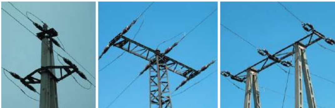
Feszítőoszlopok: háromszög vezetőelrendezés (4); egysíkú vezetőelrendezés fém oszlopon (mivel a középső átkötés felül van átvezetve, ezért kiemelten veszélyes a madarakra) (5); egysíkú vezetőelrendezés beton portál-oszlopon (ez kevésbé veszélyes szerkezet, mivel mindhárom átkötés a k.tartó síkja alatt került átvezetésre) (6).
